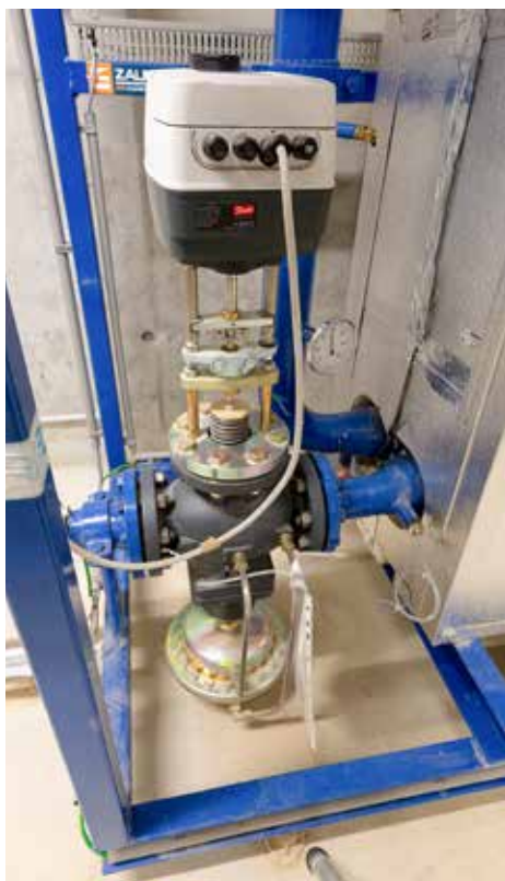
AFQM Ventil und AME 655 Motor in der Fernwärmestation sorgen für den gewünschten Volumenstrom und Differenzdruck.
