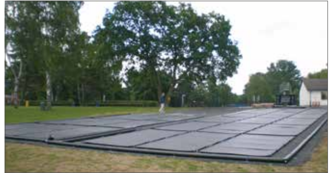
Freiflächenmontage Freibad Wehrheim
