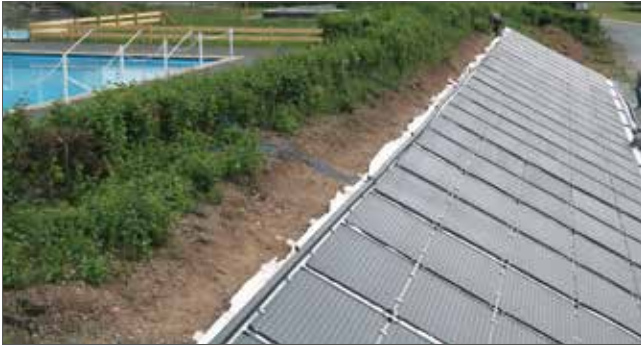
Freiflächenmontage Freibad Niedereisenhausen
